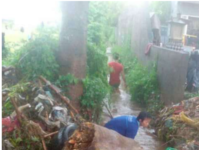
Sampah yang menyumbat Saluran Drainase
